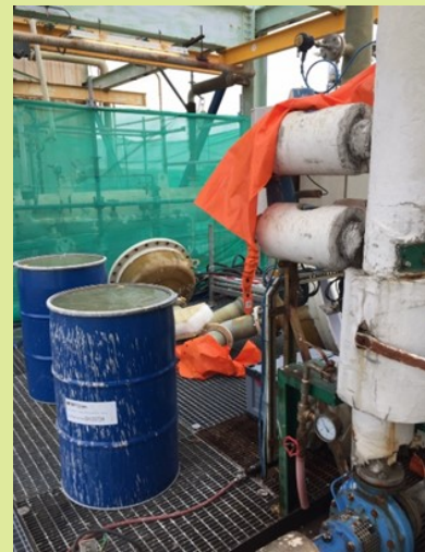
Figure n°2 : Matériel stocké dans la zone de nettoyage
