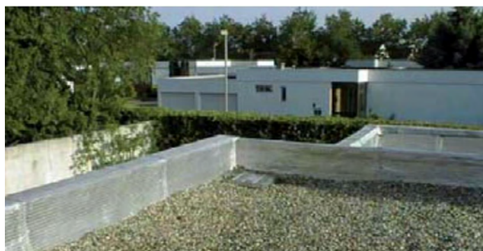
Figure 51 : Toiture-terrasse stockante (Communauté Urbaine du Grand Lyon, 2008)
