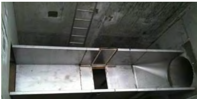
Figure 95 : Photo d'un piège à charriage à Marseille
